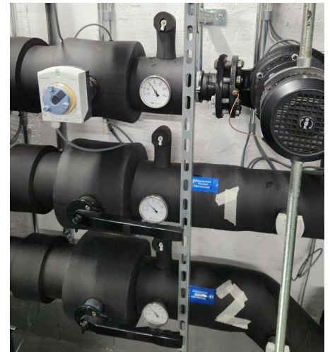
Vor- und Rücklauf der Wärmepumpe 1 und 2.
