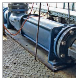
Substratförderung zwischen Fermentern
