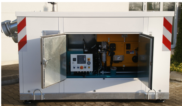
Einfacher Zugang zum Schaltschrank und Steuerung
