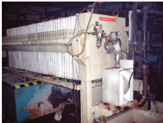
TF 200 PEU dans des conditions d'usage difficiles dans un atelier de galvanoplastie.
