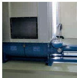
Convoyage de la boue d'épuration asséchée du décanteur vers le séchage : KL65R80.2 Pompe à vis excentrique Triplex
