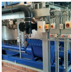
Convoyage de boue du décanteur au silo : KL65RÜ80.4 ESP avec contrôle du niveau de remplissage
