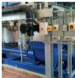
Schlammförderung von Dekanter zu Silo: KL65RÜ80,4 ESP mit Füllstandskontrolle
