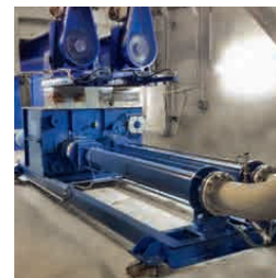
Förderung von entwässertem Klärschlamm: KL80RQ110.4+110.4 Exzentrerschneckenpumpe
