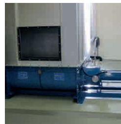
Förderung von entwässertem Klärschlamm vom Dekanter zur Trocknung: KL65R80,2 Triplex Exzentrerschneckenpumpe
