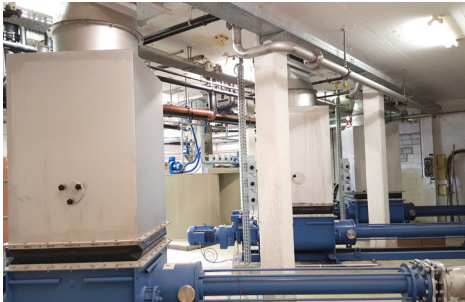
Stadtwerk Winterthur Transferpumpe ab Dekanter ins Schlammstilo
